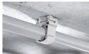
Cable conduits or light-duty pipes
